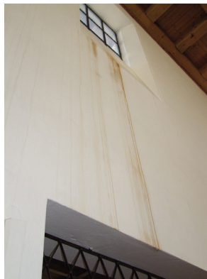
Wandschäden durch Regenwasser
