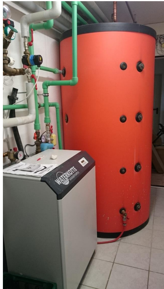
Die Wärmepumpe, ein ökologisch sehr hochwertiges Heizsystem. Foto: Hermann Hofstetter
