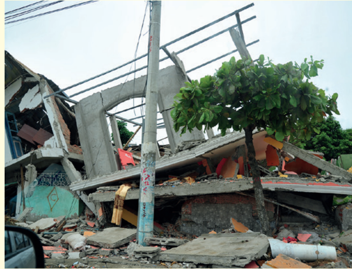
Gebäude sind wie Kartenhäuser zusammengefallen; Erdbeben in Ecuador. © Alexander Sitter
