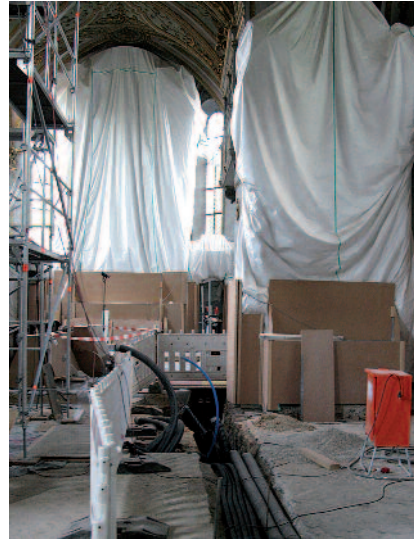
Die Kabelkanäle schaffen Ordnung im Gewerk
