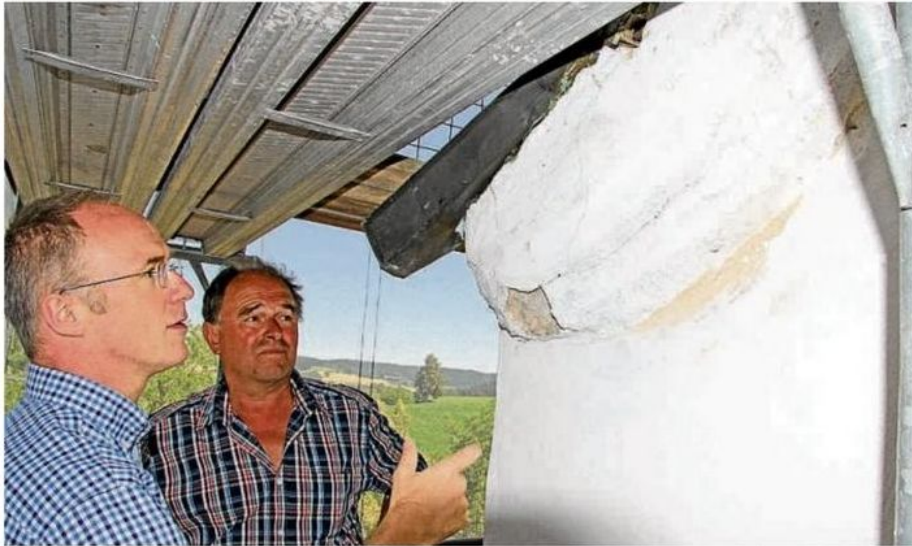
Skeptische Blicke: Schreiner Martin Huber (l.) und Architekt Markus Heilmaier vor dem beschädigten Traufriegel. FOTO: TOM
